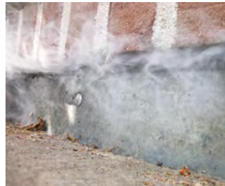
Prueba de un sellado deficiente de conexiones a pared por encima de un garaje subterráneo.
