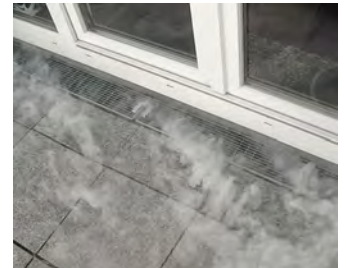
Sellado deficiente de azoteas.
